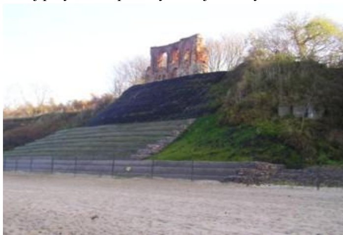
Zabudowa ochronna (gabiony) klifu w Trzęszacu – ochrona resztek ruin kościołka z XVI w.
